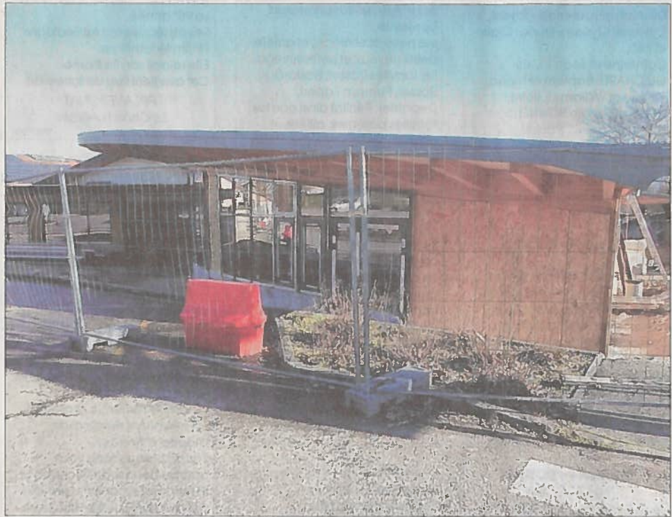
Les travaux d'agrandissement de l'école touchent à leur terme. Photo Le DL/G.D.
