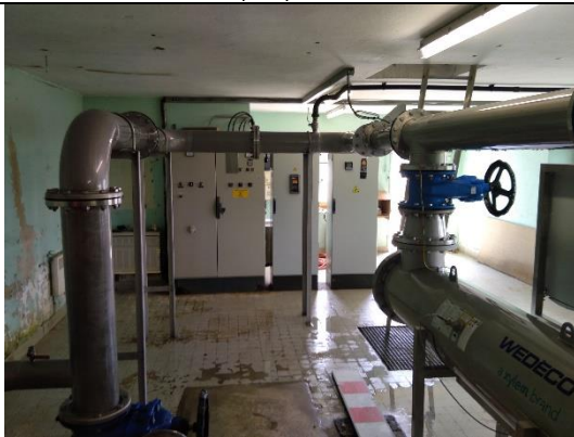
Vue sur les armoires électriques rénovées
