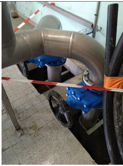
Nouvelles pompes de 160 m 3 /h
