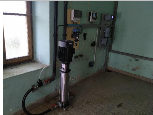
Installation de chloration permettant d'assurer un résiduel minimum
