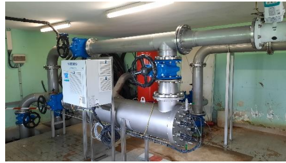
Installation de désinfection UV
