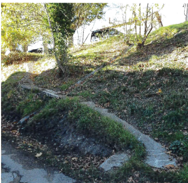
Cheminement piéton peu accessible à améliorer.
