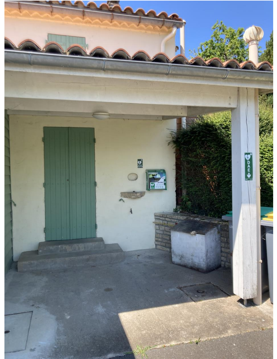
SALLE DES FETES – Auvent entrée cuisine
