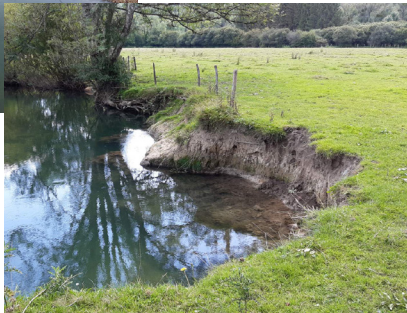
L'érosion d'une berge sans ripisylve
