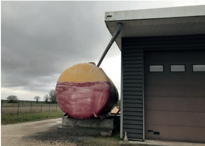
Récupération des eaux de pluie pour les arrosages extérieurs.
