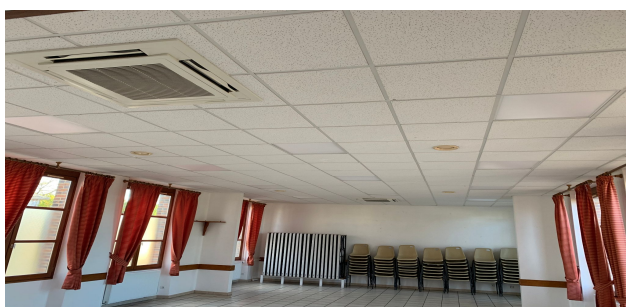
Nouvel éclairage salle des Fêtes de Saint-Sauveur
