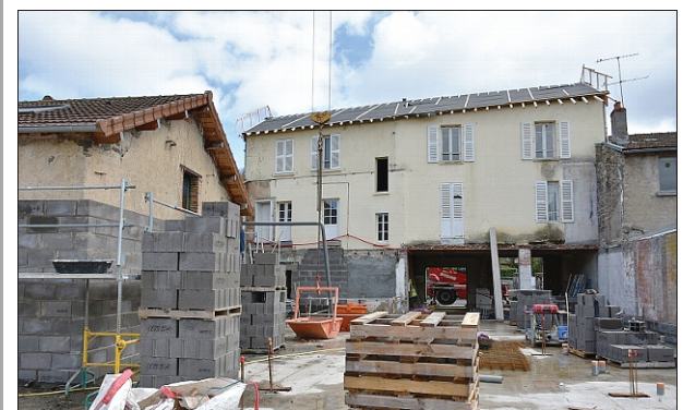
RÉALISATION. Un vaste projet de réhabilitation-extension porté par la CC de Chavanon Combrailles et Volcans.
